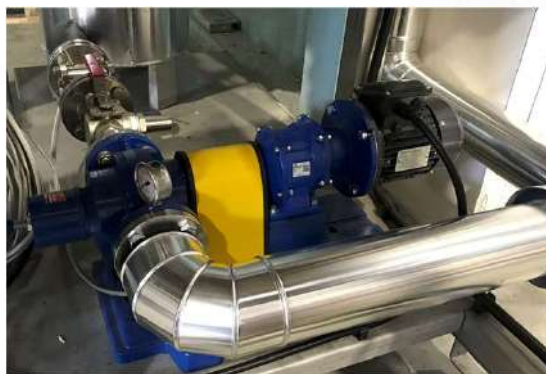
Pompa di mandata principale
