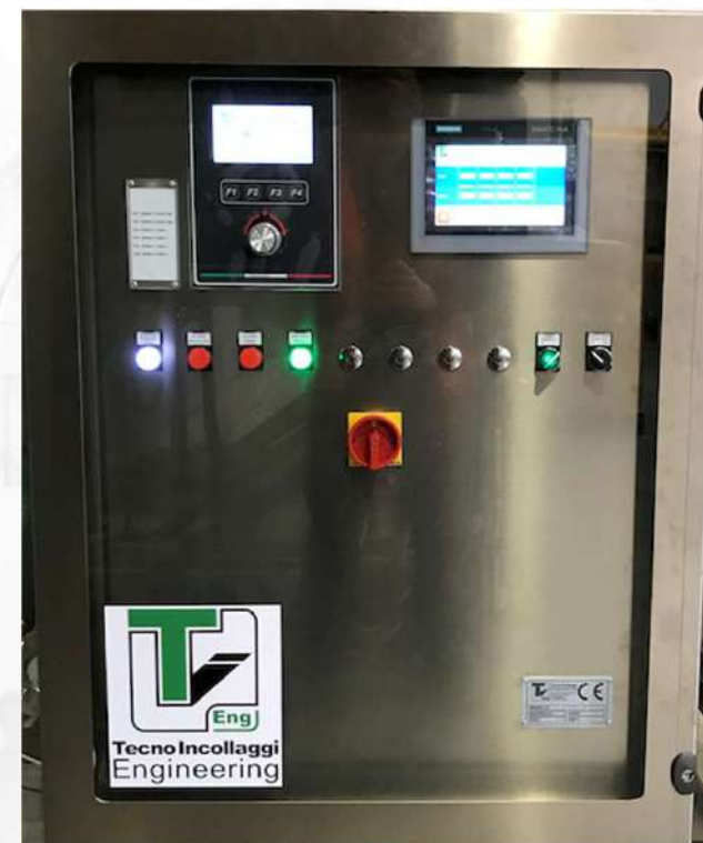
Quadro elettrico generale
